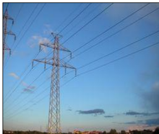
Figura 32 – Elettrodotto ad alta tensione
